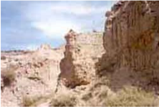
1.- Barranco Rancepech, se aprecia la fuerte erosión de sus paredes, con el consiguiente arrastre de tierras.
